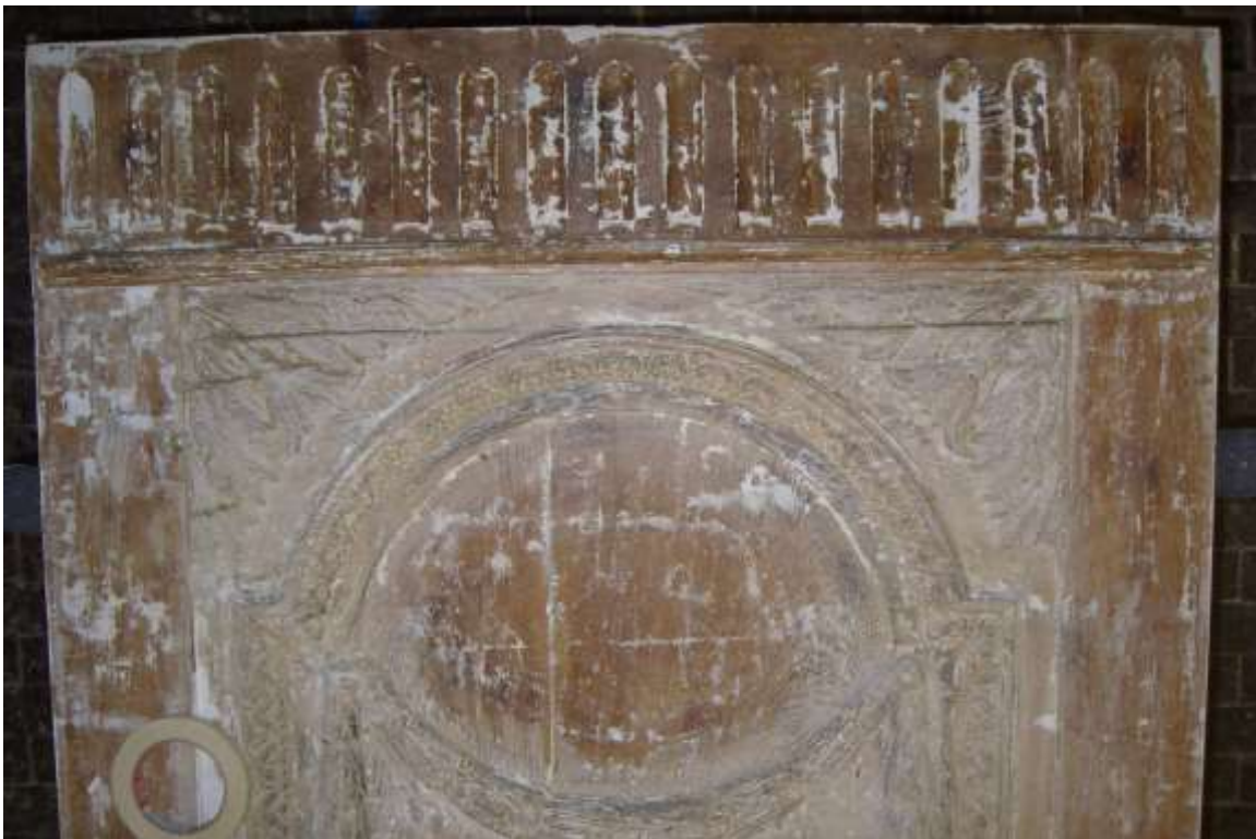
Abb. 30: Detail Risse sowie geöffnete Fuge Türblatt außen
