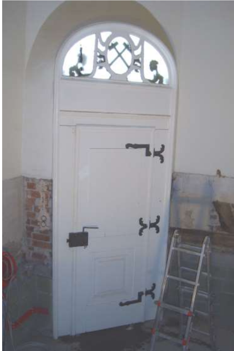
Abb. 4: Innenansicht der Tür vor der Restaurierung
