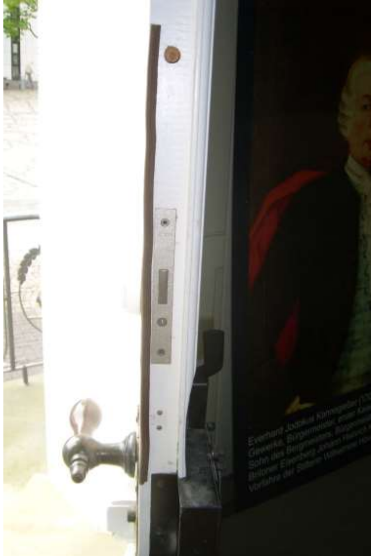
Abb. 65: Detail Riegelschloss und Alarmanlagensensoren
