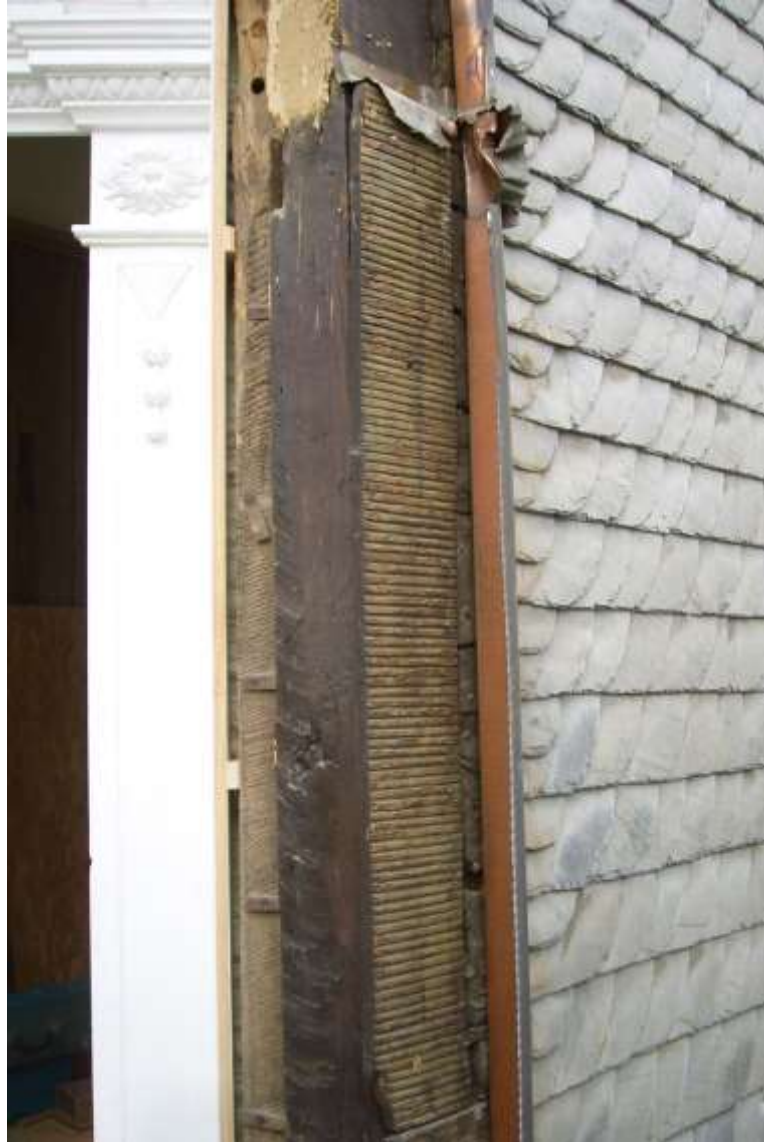
Abb. 28: Rest der ursprünglichen äußeren Verkleidung
