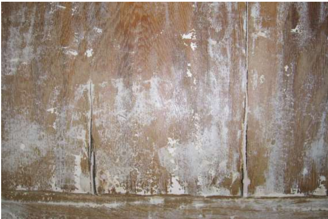
Abb. 17: Detail ausgekittete Risse, Kittmasse von den Flanken abgerissen.
